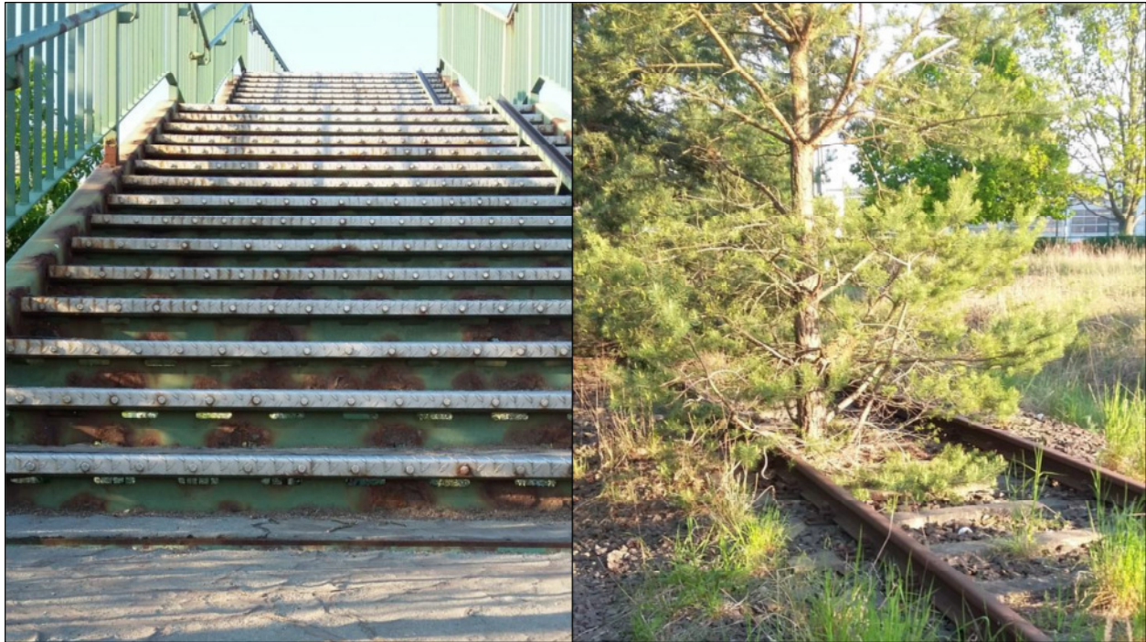
Abbildung 4: Riss- und Korrosionsbildung an der Fußgängerbrücke (links) und vorhandene Vegetation auf brachliegenden Gleisanlagen (rechts)
